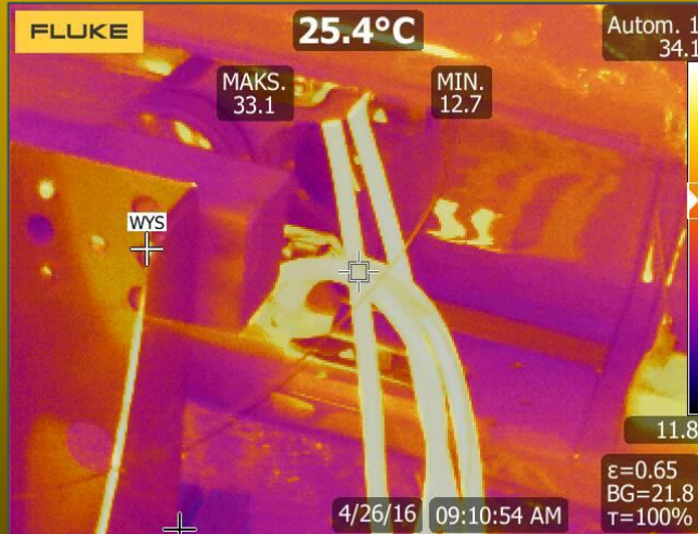
Termogram przewodów wyjściowych
